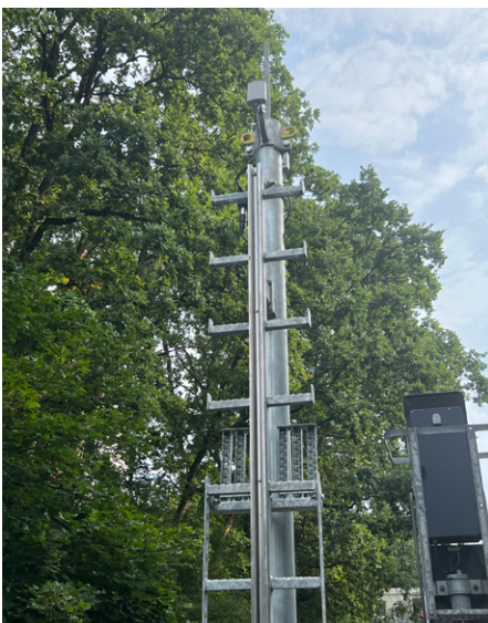
Bild 1: Beispiel eines WLAN-Systems für ein U-Bahnsystem (Hamburger Hochbahn)
